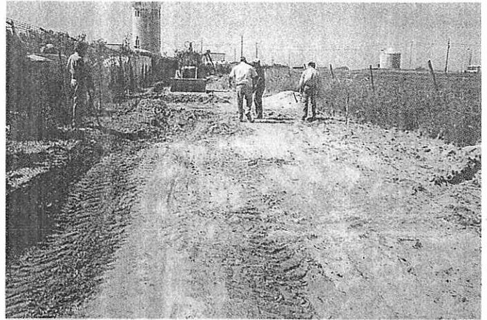
REPAVIMENTAÇÃO DO ACESSO AO BAIRRO JOAQUIM DA COSTA - Obra da Junta de freguesia do Porto Covo com o apoio da Câmara Municipal de Sines
