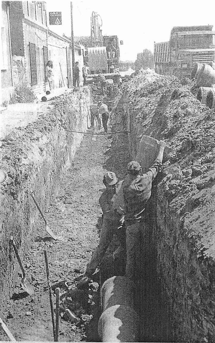
INFRAESTRUTURAS DE SANEAMENTO BÁSICO NA SONEGA Obra conjunta das Câmaras Municipais de Sines e Santiago do Cacém
